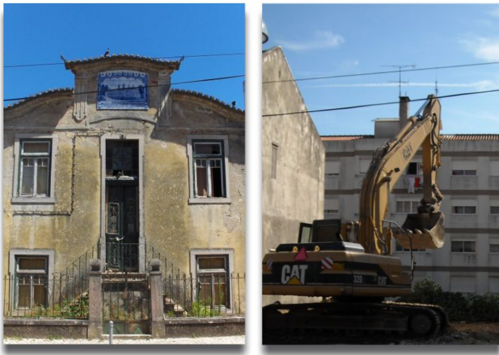
Figura 24 - Fotografia do Chalé de pintor Stuart Carvalhais a 29 de Junho de 2009 e a sua demolição a 30 de Outubro de 2009. Fotos do autor.
